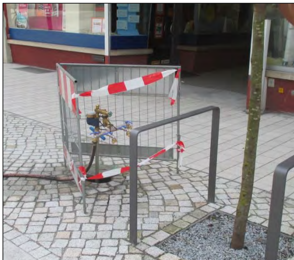
(Foto: Wasserentnahmestelle im Funktionsband)
